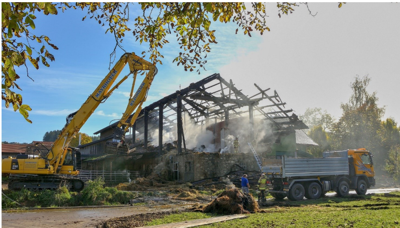
Das Wirtschaftsgebäude des Greischbergerhofes am Morgen nach dem Brand.
